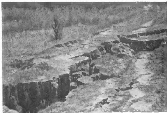
Рис. 5. Трещина в лессовидных суглинках, образовавшаяся на земной поверхности при девятибалльном землетрясении в Средней Азии. Такие же трещины образовались при землетрясении 1885 года
